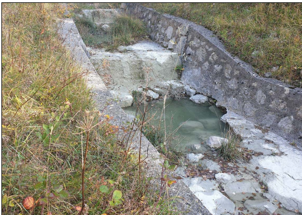
Slika 6. Oštećena slapišta uslijed čestih djelovanja vode, dionica 1 (Duel Projekt d.o.o.)
