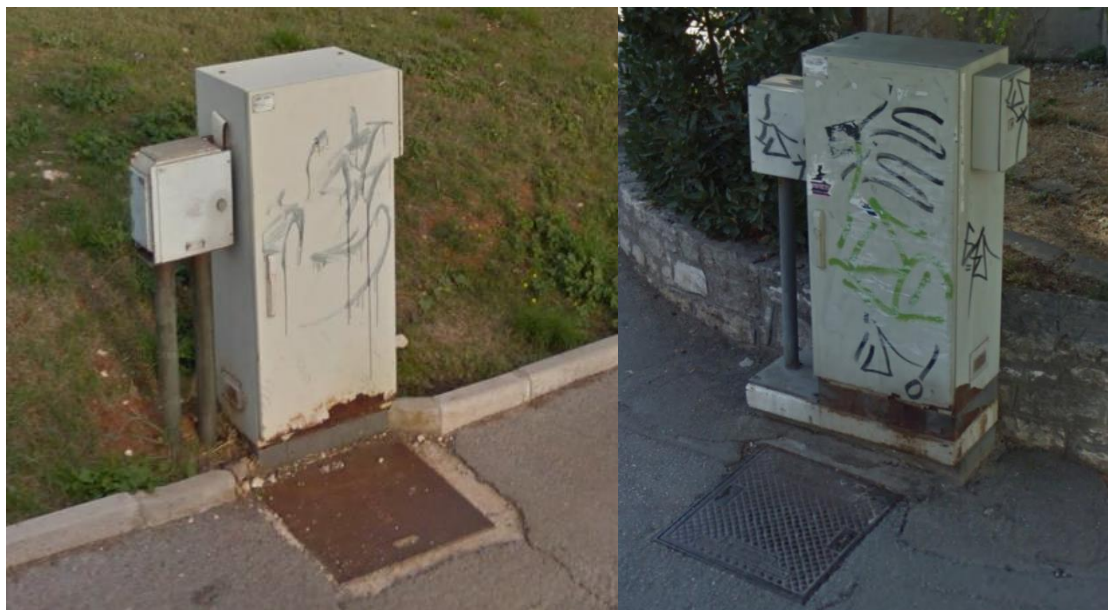
Fotografija 21. Korodirala kućišta semafornih uređaja
