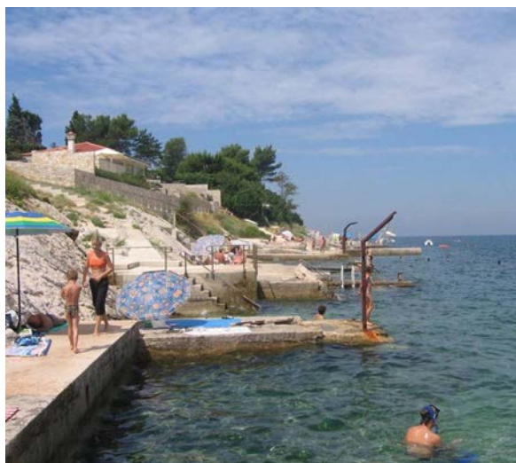
Slika 80: Degradacija obale betoniranjem
