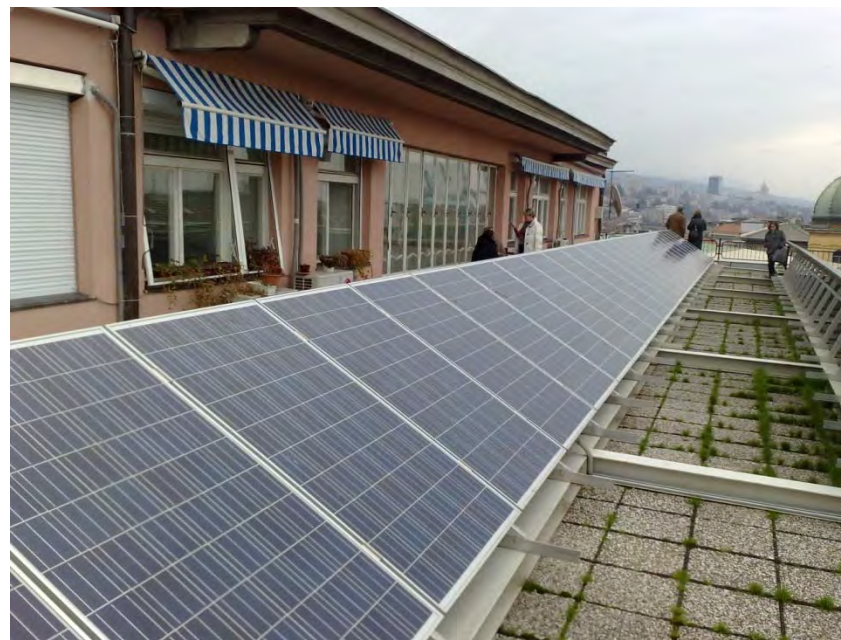
SE Upravna zgrada grada Rijeke, 10 kW
