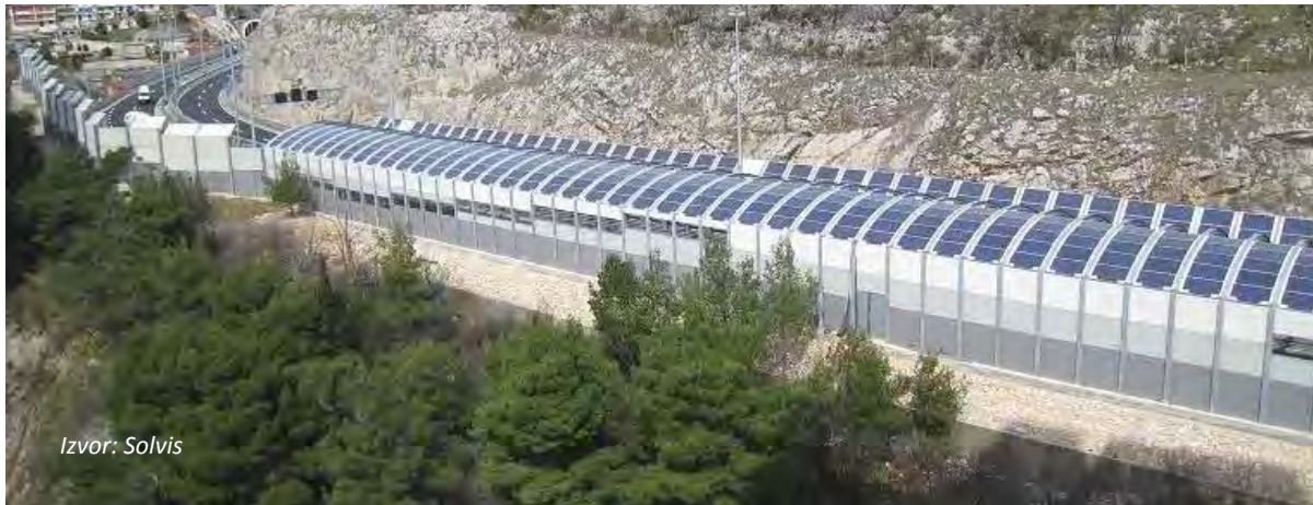
Fotonaponski moduli na bukobranu riječke obilaznice, 254 kW
