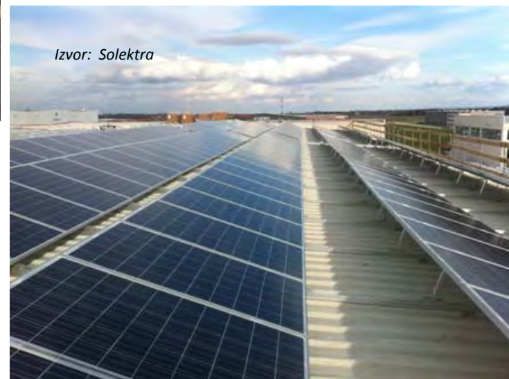
SE Gumilmpex, 1 MW, Varaždin
