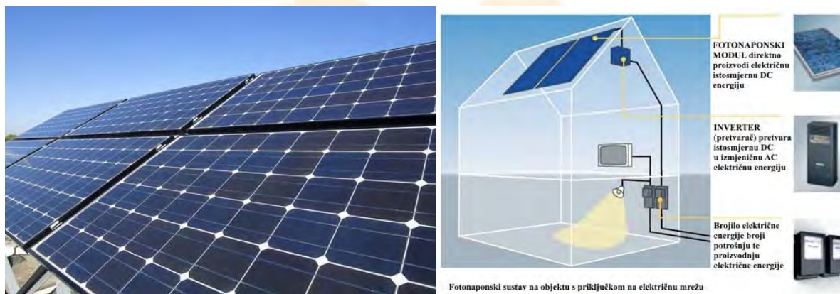
Fotonaponski sustav na objektu s priključkom na električnu mrežu
