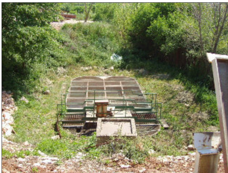
Fotografija 8. Uređaj za pročišćavanje otpadnih voda.
