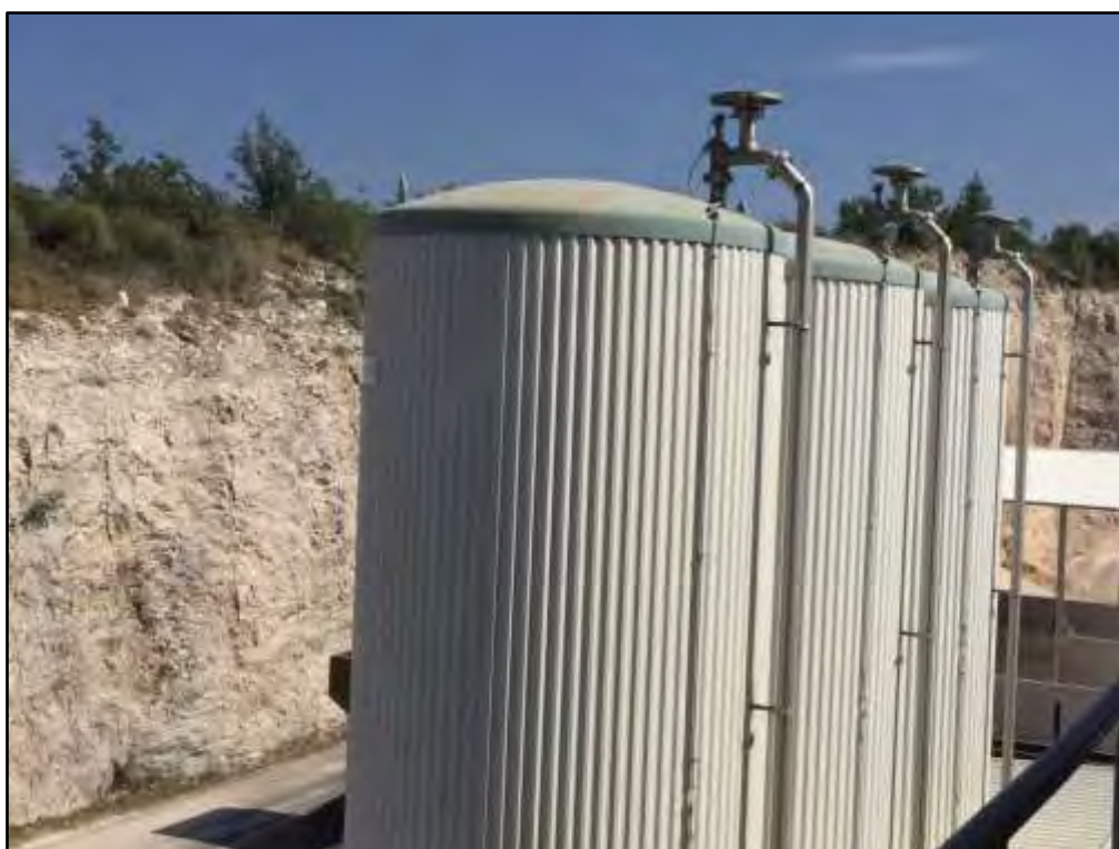
Slika 6: Spremnici bitumena (vertikalni spremnici)
