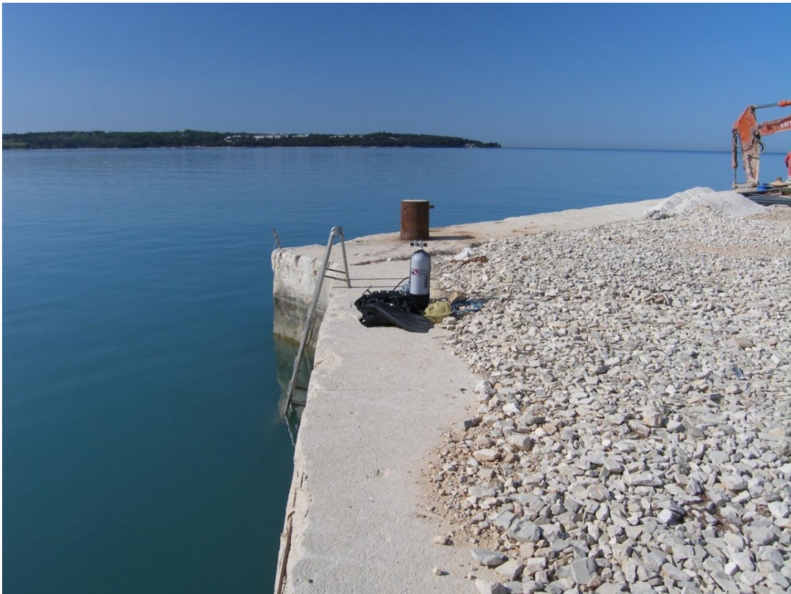
Slika 7.67. Betonska obala na na pretovarnoj rivi eksploatacijskog polja Antenala. Vidi se oprema za autonomno ronjenje. Ronilac je iskoristio ljestve koje su postavljene radi popravka rive.
