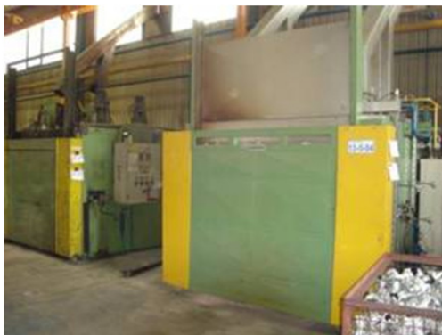
Slika 6: Peći za spaljivanje jezgri u ljevaonici Roč
