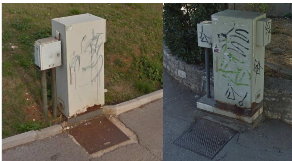
Slika 71. Korodirala kućišta semaforških uređaja
